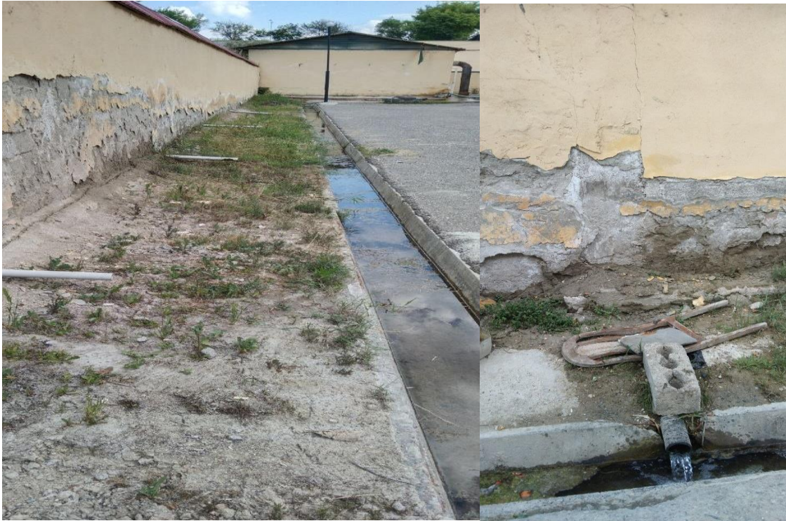
1-rasm. Nasos stansiyasidagi sizot suvlarining oqibatlari
